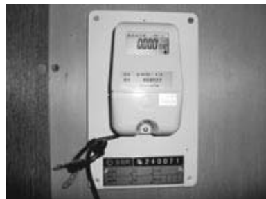
各家庭の壁等に設置されている表示器
