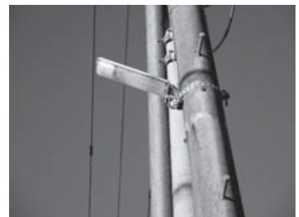
LED化された街路灯
