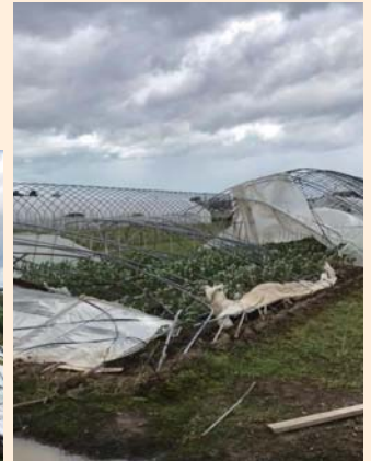
町内各地で農業用 ビニールハウスが倒壊 被害棟数 334 棟 (9月18日現在)
