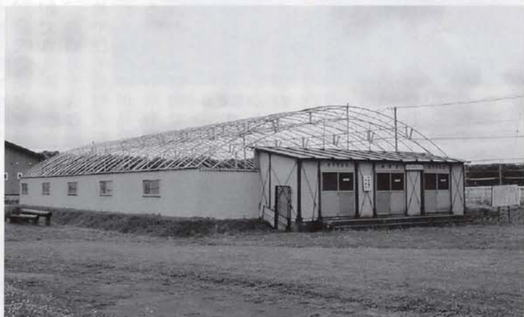
解体撤去が望まれる東裏小学校プール
