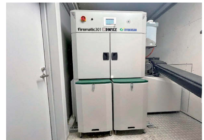
木質チップボイラー本体
