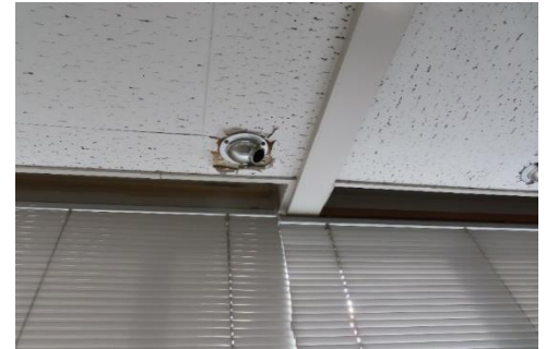
天井の換気口付近のひび割れ
