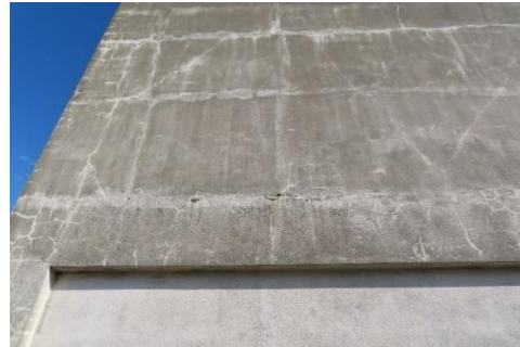
庁舎北側外壁の亀裂、欠損
