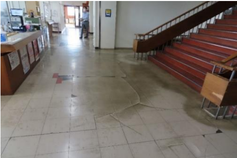
床の亀裂と傾斜
