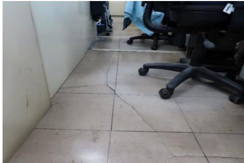
執務スペースの床の亀裂と傾斜
