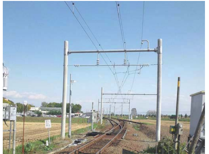
電化地上設備（北海道医療大学駅付近）
