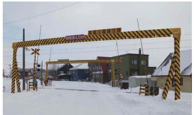
踏切の高さ制限標 H鋼式（南2号線踏切）
