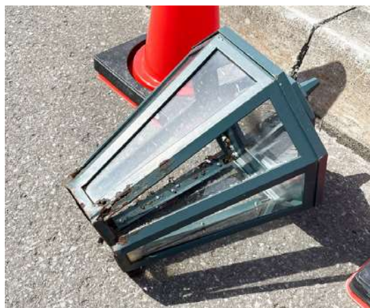
落下した灯具（当別駅前）
