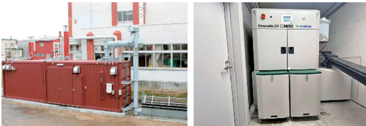
写真5 西当別小中学校木質チップボイラ導入事業
