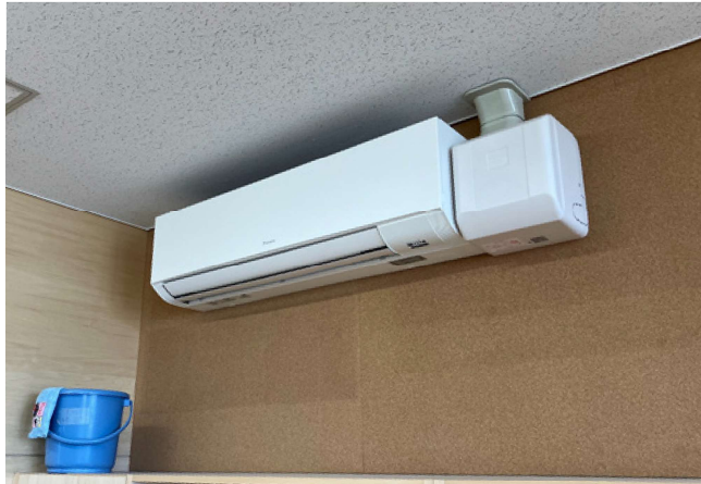
とうべつ学園に新しく設置されたエアコン
