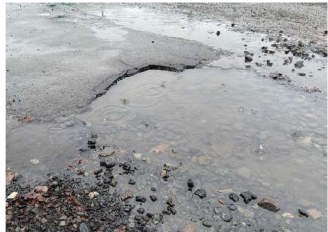
道路の凹凸に雨水が溜まっている様子（イメージ）
