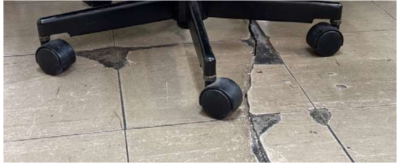
亀裂が入っている庁舎の床
