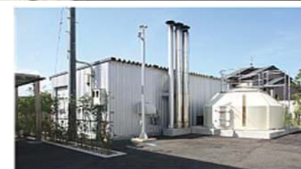
集中型ペレットボイラー設備
