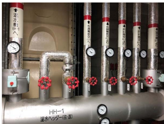
温水ヘッダー・配管の状況
