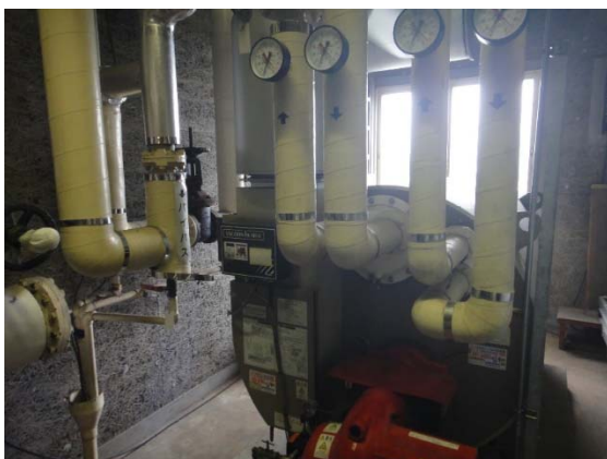
旧館ボイラー室内部（581kW 真空ヒーター）
