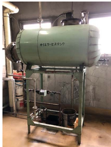
オイルサービスタンク
