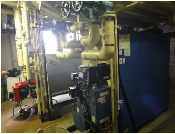
ボイラー室内部（真空ヒーター）
