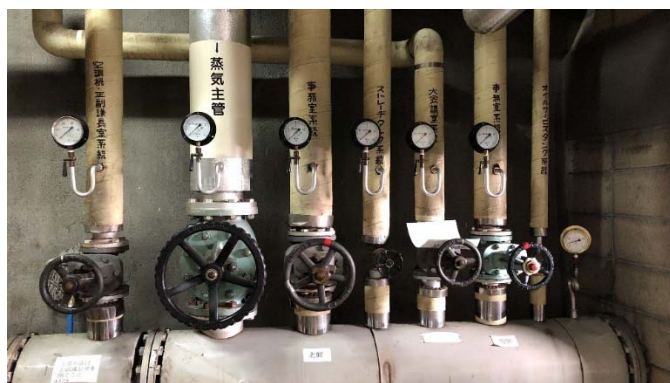
主管蒸気ヘッダー
