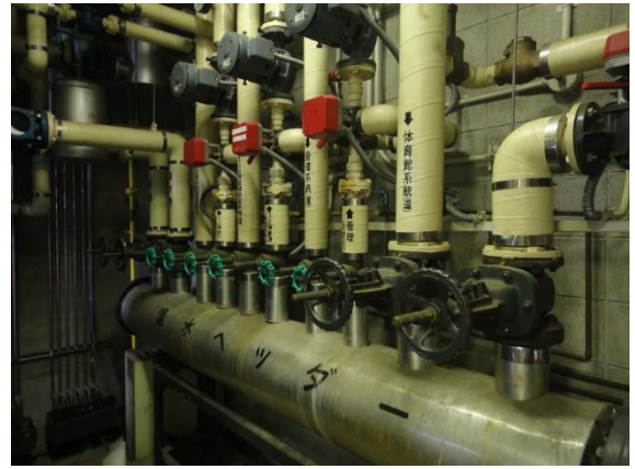
温水ヘッダー・温水配管
