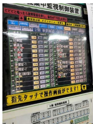
職員室の集中監視制御装置
