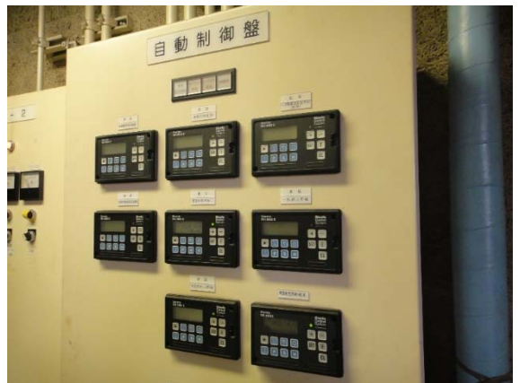
ボイラー室内の自動制御盤
