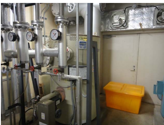
新館ボイラー室内部（232kW 真空ヒーター）
