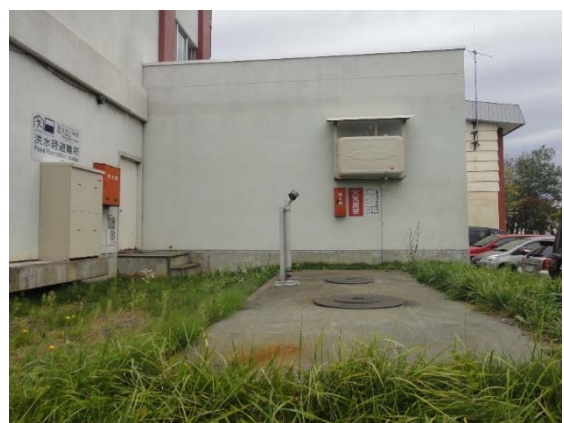
ボイラー室前の重油タンク
