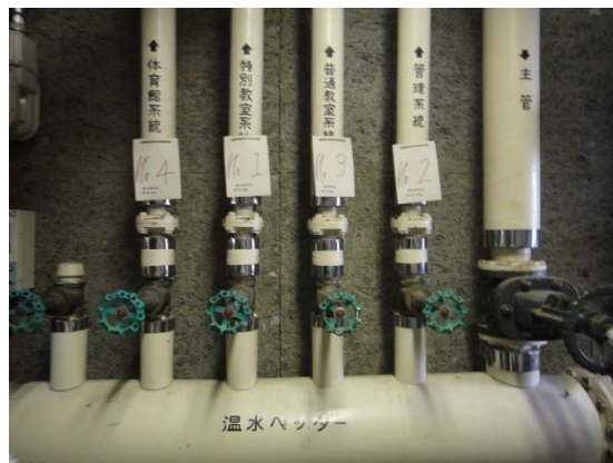
温水ヘッダー・温水配管
