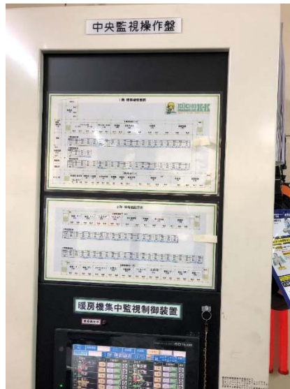
職員室中央監視操作盤
