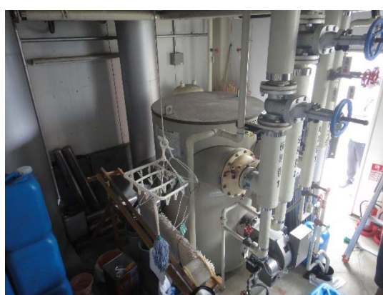
プール機械室灯油ボイラー
