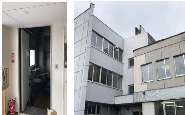
役場庁舎 4 階にあるボイラー室
