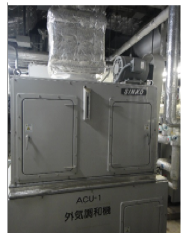
エアチリングユニット (空調システム)
