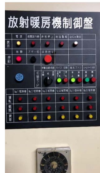
体育館放射暖房機制御盤
