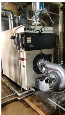
小型貫流蒸気ボイラー
