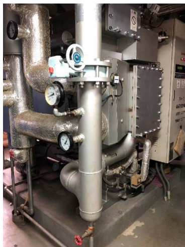
吸収式冷温水発生機
