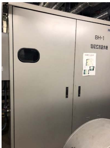
吸収式冷温水発生機
