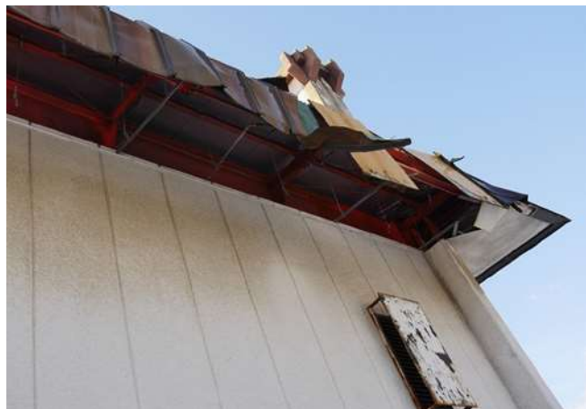
屋根が一部剥がれてしまった白樺コミセン
