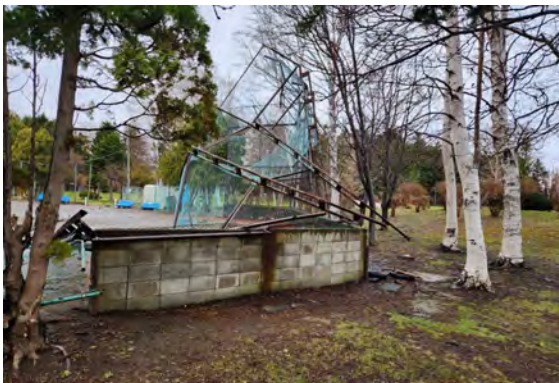
倒壊直後の野球場バックネット
