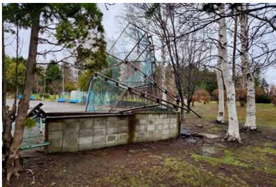
倒壊直後の野球場バックネット
