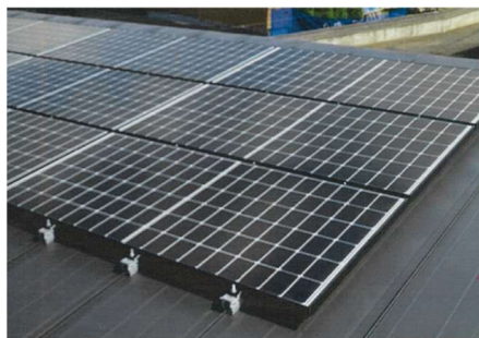
太陽光発電設備
