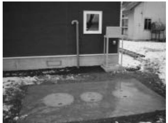
左上図の小型合併浄化槽が 地中に埋設され設置工事が完成
