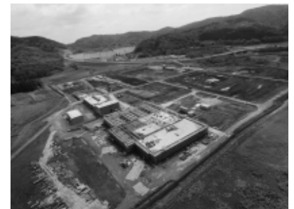
平成25年から水を供給する当別浄水場
