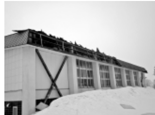
4月4日、発達した低気圧による強風で屋根がはがれた弁華別中学校の体育館
