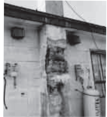
崩れ落ちている集合煙筒
