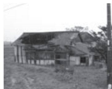
壊れたまま放置された空き家。景観上、防災上、一刻も早い対策が必要である
