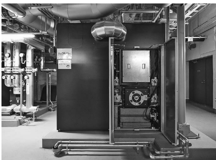
写真42 とうべつ学園のボイラー室
