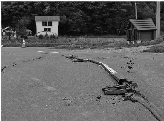
写真3 道路に亀裂が発生した町道20線
