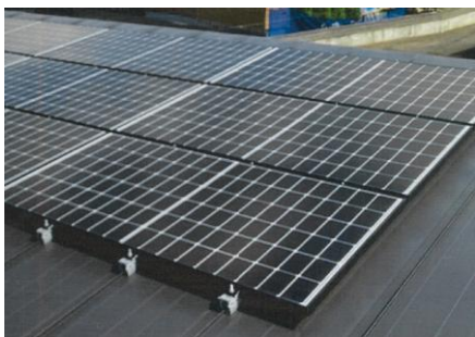
太陽光発電設備
