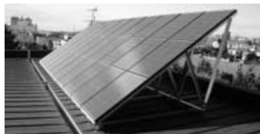
住宅用太陽光パネル
